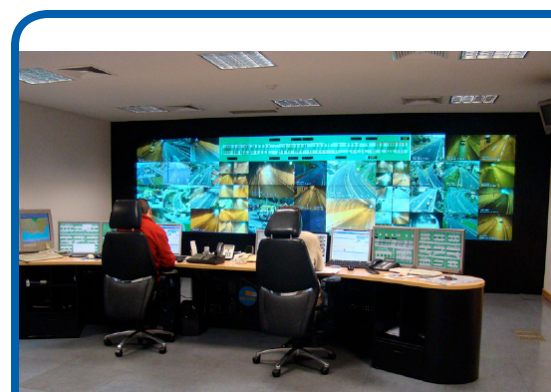
Gestión de Tráfico, Peaje SCUT, Control de 30 Túneles en Vía Rápida ER-1, y Centro Control en Funchal (Madeira-Portugal, VIALITORAL).
